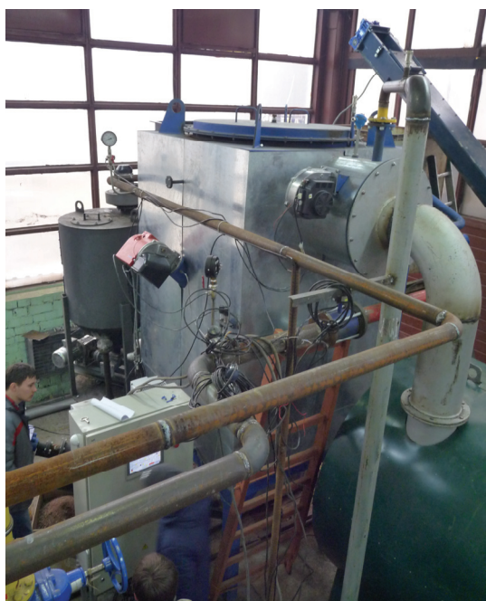
Рис. 1. Внешний вид котла КС-5
