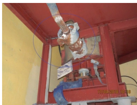
Рис. 2. Коррозионный износ трубопроводной обвязки мерника раствора едкого натра
