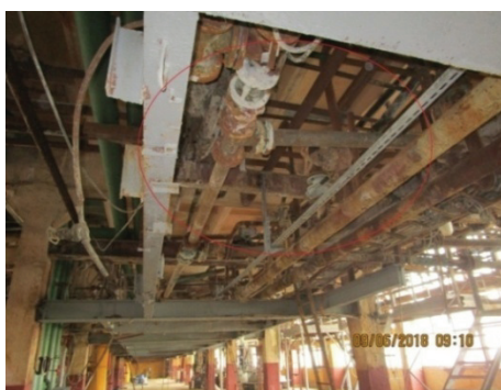
Рис. 1. Коррозионный износ наружной поверхности трубопровода и его деталей
